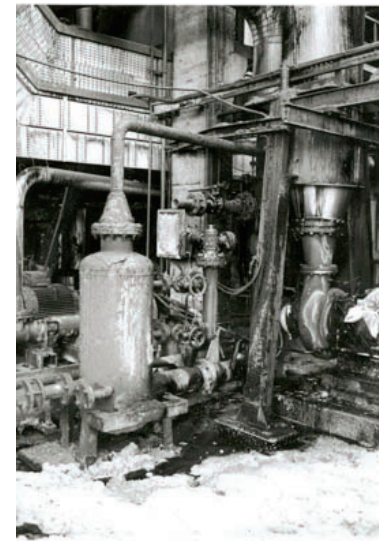
Vue partielle de l'atelier cuisson
